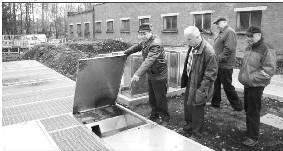
Riebiņu novada domes Komunālo pakalpojumu nodaļas vadītājs Roberts Kabakovs (pirmais no kreisās) informē pieņemšanas komisiju par jauno sadzīves notekūdeņu bioloģisko attīrīšanas iekārtu darbību.
